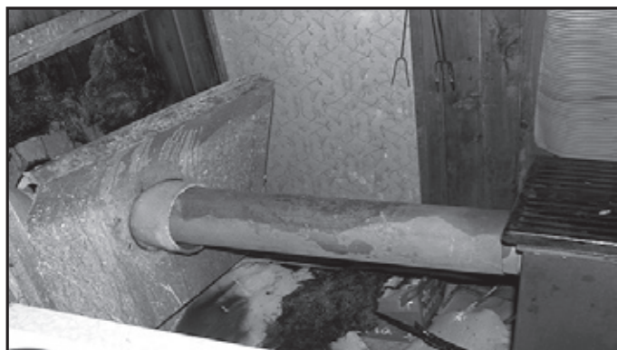
I takto může být provedena instalace topidla s kouřovodem. Včasným zpozorováním došlo pouze ke shoření části dřevěného obložení stěny.
